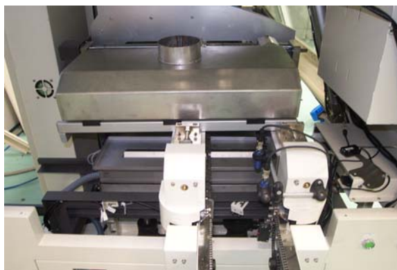
La hotte est installée au dessus de l'ensemble de fluxage.
